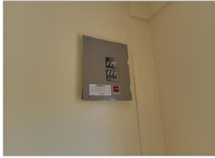
Caja de breakers
